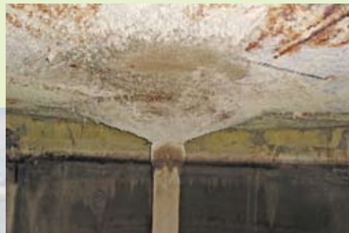
▲ Die Folgen fehlender Betonschutzfolie
