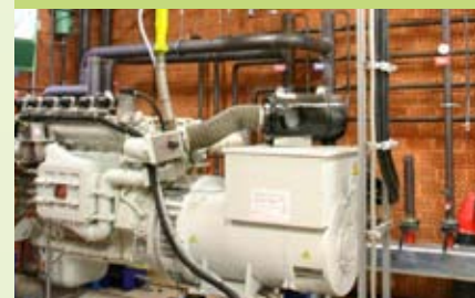
▲ BHKW-Raum mit Schallschutzwand
