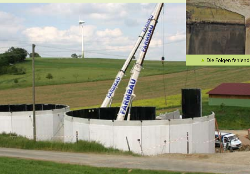
Fermenter mit Betonschutzplatte und Wärmedämmung
